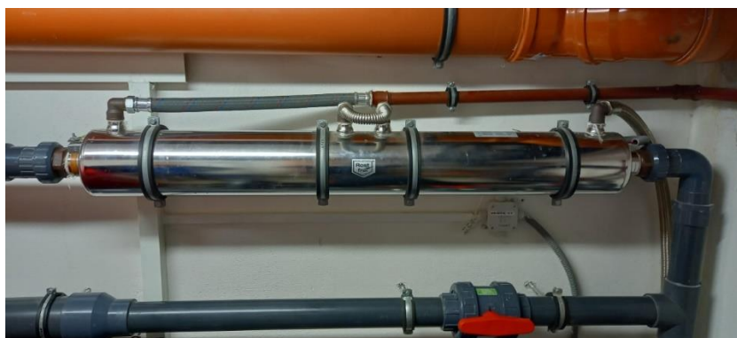
Obrázok 2: Rúrový výmenník tepla v strojovni plaveckého bazéna [Autor]
