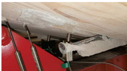
Obr. 29 Poškodenie drážky a obnaženie rozkovanej hlavy.
