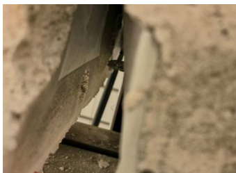
Obr. 27 Detail porušenia výstuže na vzorke v dôsledku overovania.
